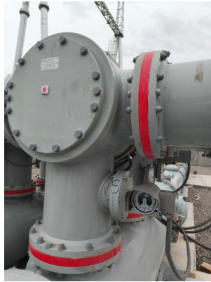
图1 国网电力甘肃某电场GIS设备
